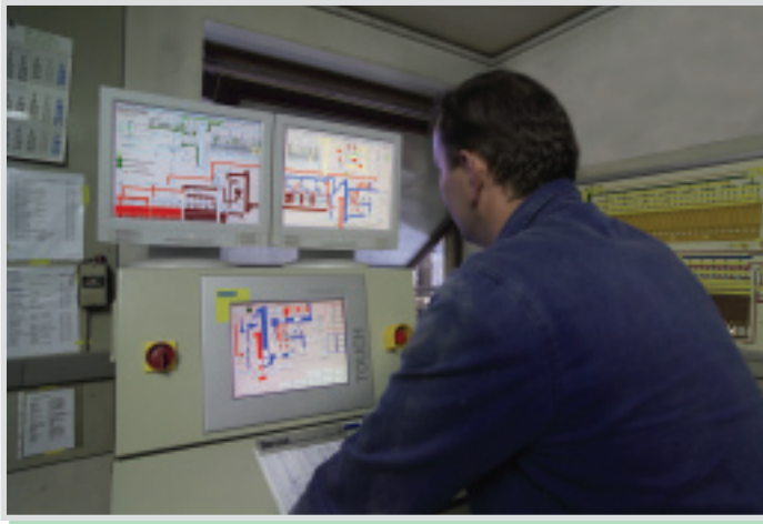
Kompakt, komfortabel Das neue Bedien- und Beobachtungssystem im Futtermittelmischwerk von Raiffeisen Breitenfelde, mit WinCC-Datenserver und zwei Dat@Monitor-Client
