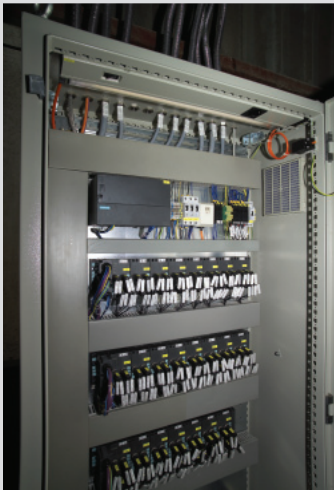
Die dezentralen Peripheriegeräte ET 200X im Vor-Ort-Schaltschrank sind mit der Simatic S7-300-Steuerung über Profibus DP verbunden
